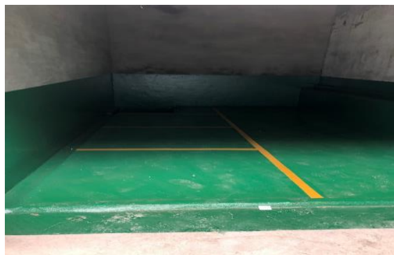
门口有缓冲破+导流沟
