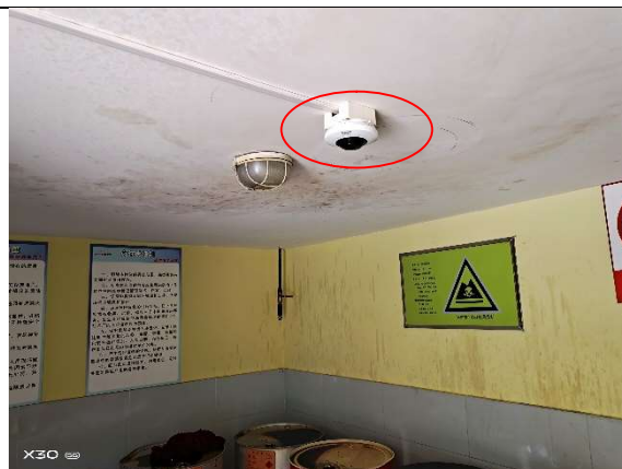
15m 2 危险废物暂存库监控摄像头
