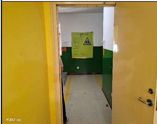
机修车间 2 楼 40m 2 危险废物暂存库（贮存危险废物种类：废原料包装桶、废地棉）
