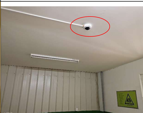
40m 2 危险废物暂存库监控摄像头
