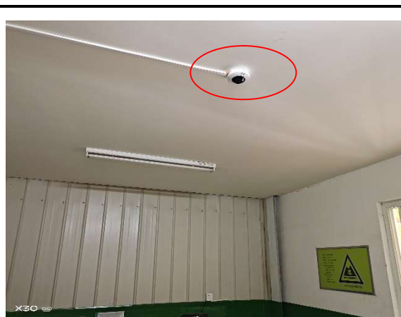
40m 2 危险废物暂存库监控摄像头
