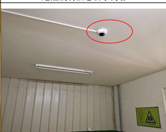
40m 2 危险废物暂存库监控摄像头
