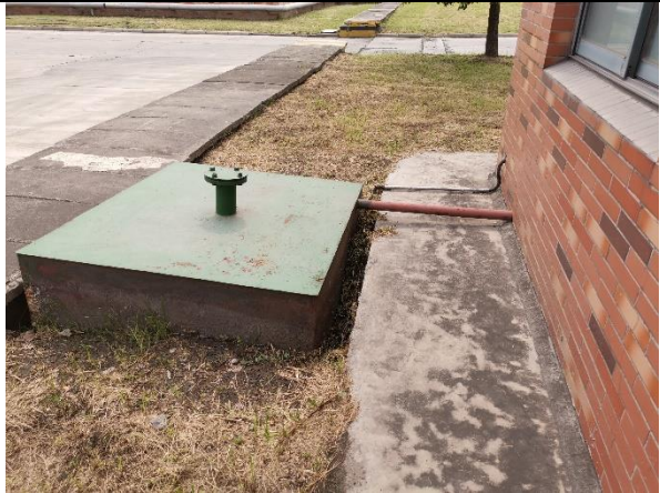
危险废物暂存库应急收集装置
