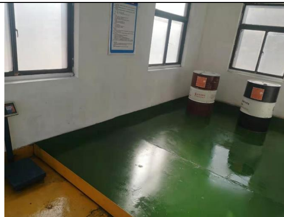
危险固废暂存库内防渗漏设施
