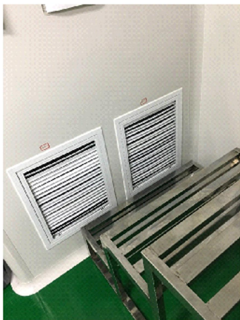
车间废气集气口
