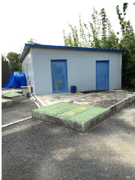
园区污水处理设施
